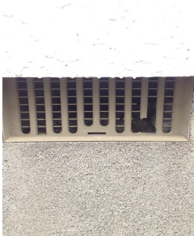
床下通気口の破損部分
