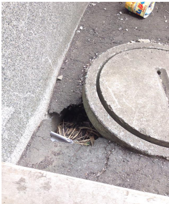
敷地内マンホール脇の亀裂部分
